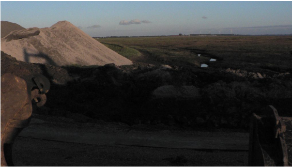
Figuur 3.3. Werkzaamheden aan de zeedijk op de grens van Hollare- en Van Haftenpolder met schor Krabbenkreek, 26 mei 2010 (ts).
